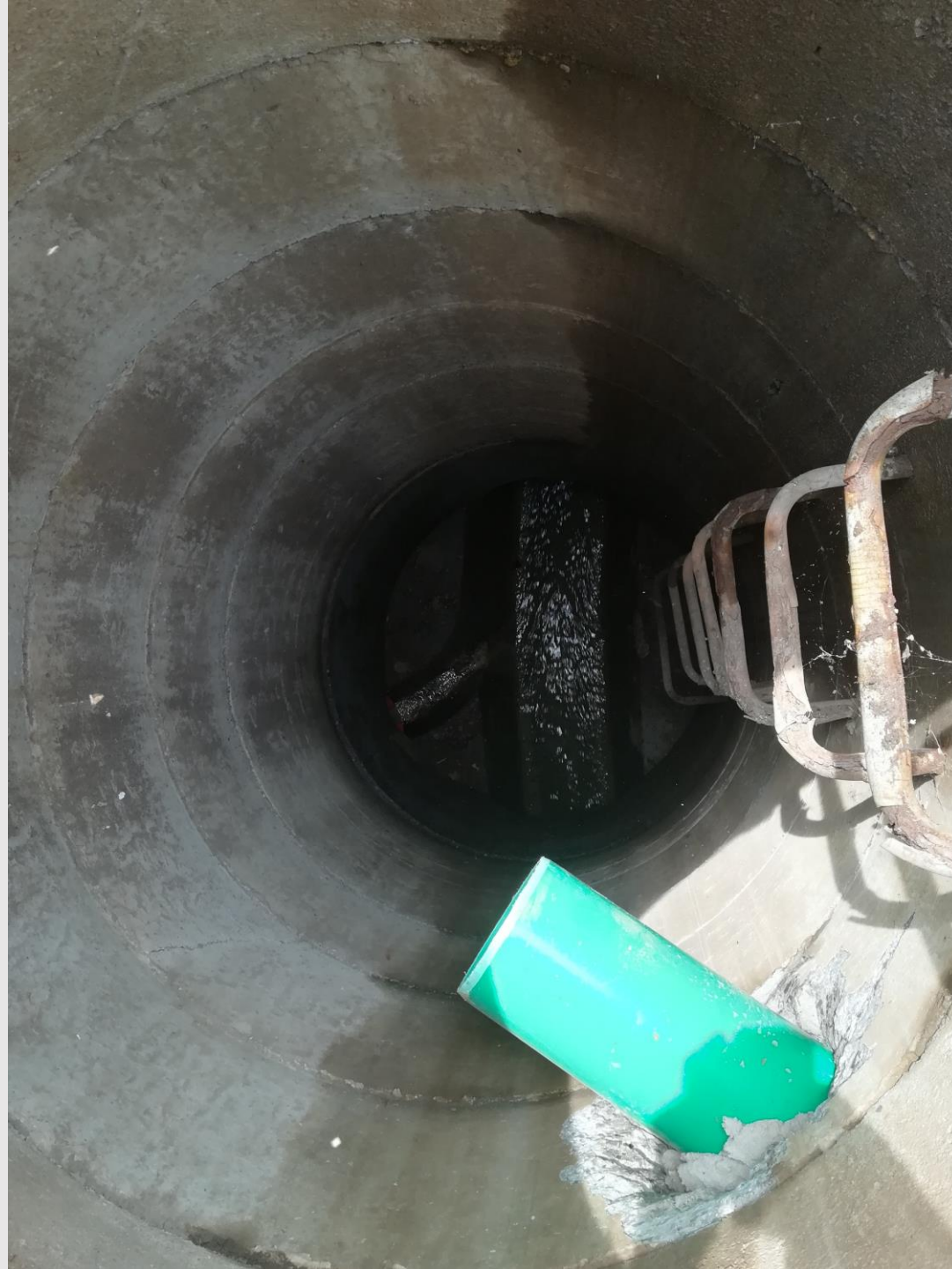
Falschanschluss in den Sammler. Diese Einleitung zerstört das Betonbauwerk und wurde deshalb bereits vom Verursacher umgebaut.
