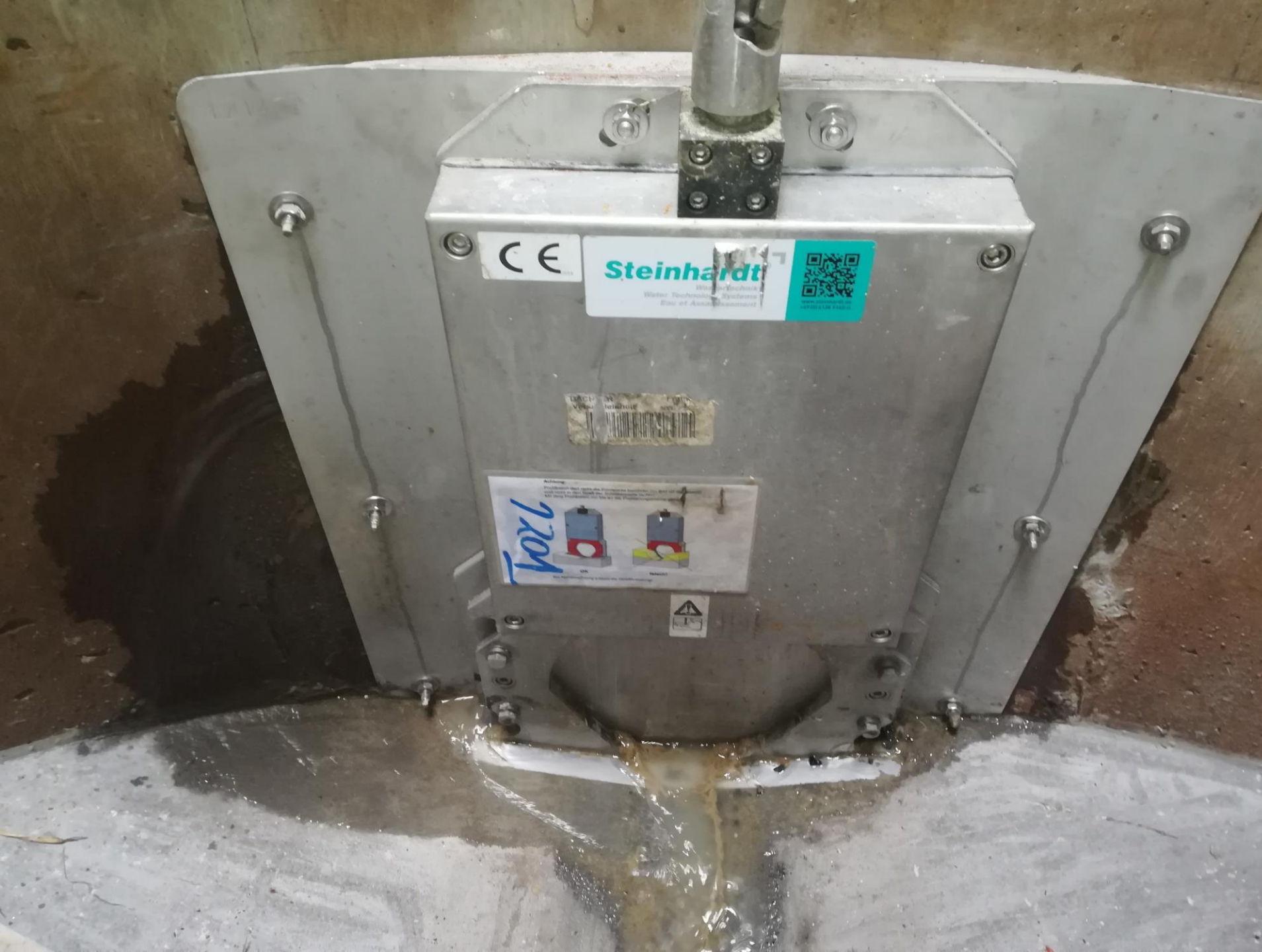
Ablaufschieber im Regenklärbecken Thüringen. Dieser wurde auf ein Maximum von 60 l/s erhöht
