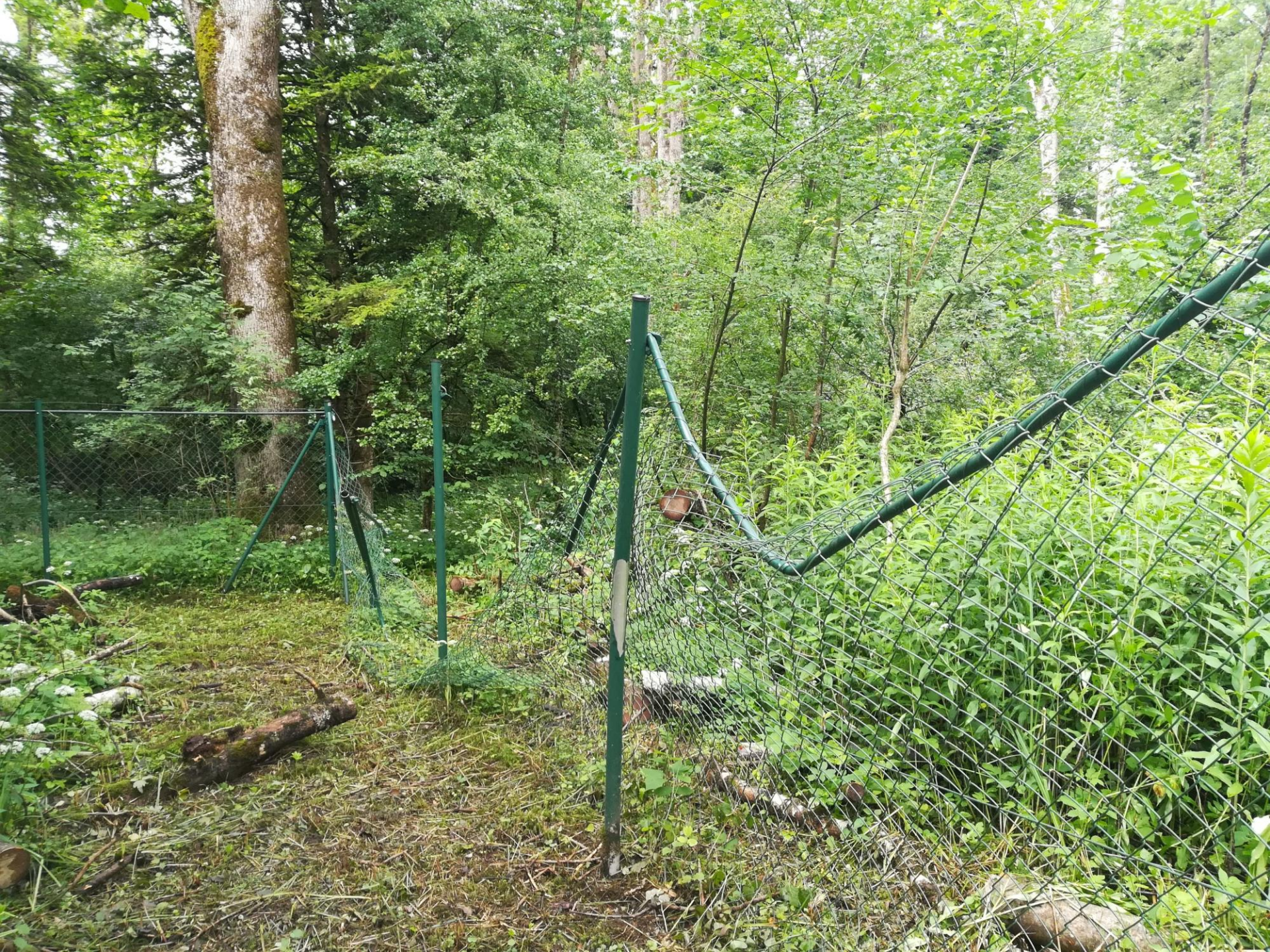
Sturmschaden an der Umzäunung
