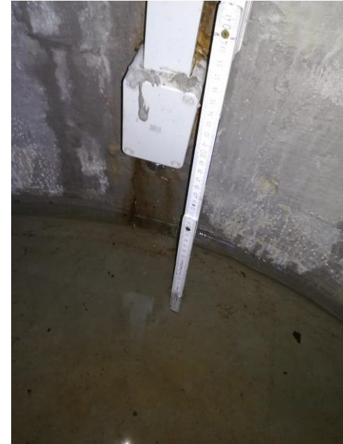
Wasser im Messschacht
